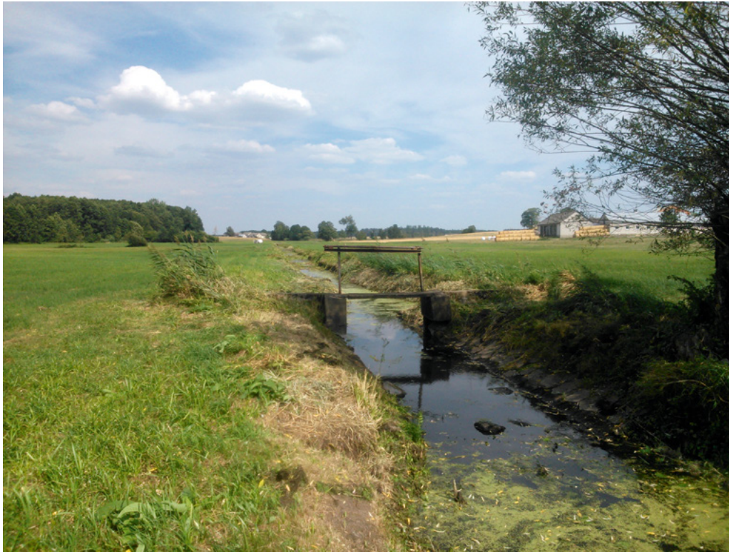
Fot. 12. Zniszczony jaz zastawkowy na uregulowanym strumieniu w krajobrazie rolniczym (fot. P. Prus)
