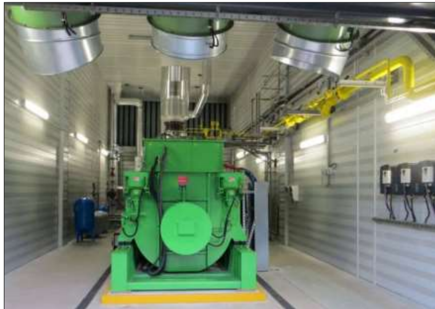
Przykład: Uruchomienie przez MEC Piła jednego z najnowocześniejszych źródeł ciepła w kraju: kogeneracyjna elektrociepłownia produkująca równocześnie ciepło i prąd
