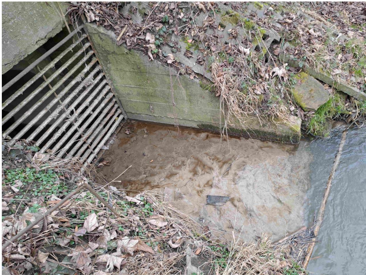
Wylot kolektora \varnothing 1000 mm (?) (prawdopodobnie przelewu burzowego), około 30 m poniżej stopnia, na lewym brzegu Prądnika - kolizja z ewentualnymi planowanymi nasypami
