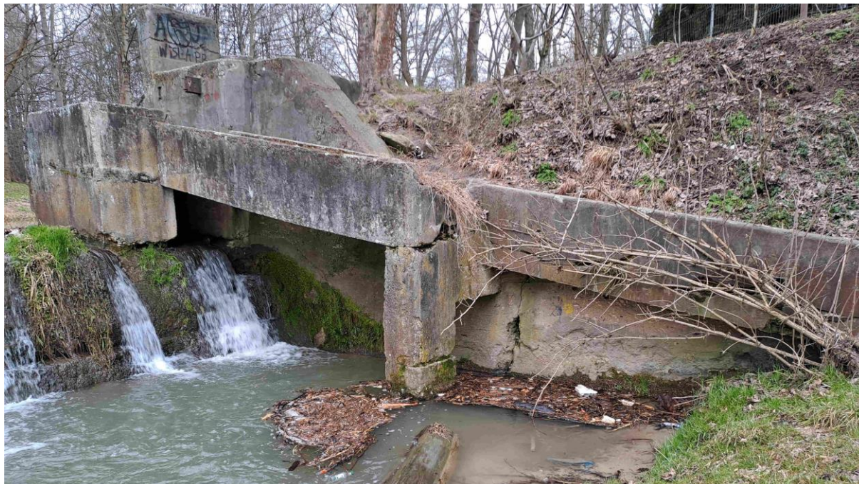
Stan konstrukcji przepławki wskazujący na brak powiązania strukturalnego z konstrukcją stopnia
